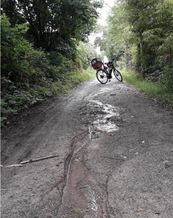
1. Bahnseitenweg zwischen Ostenbergstr. und An der Palmweide, Drainage fehlt, tief ausgewaschene Rillen, Quellwasser läuft über den Weg, Schulweg der Ostenberg-GS, wichtige Radfahrverbindung Barop – Dorstfeld;
