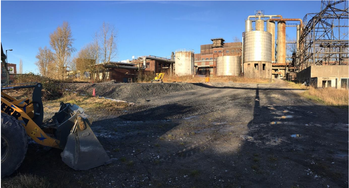
Vorarbeiten für die Erstellung des Fundaments im Februar 2022 (Foto: Stadt Dortmund, Dagmar Knappe)
