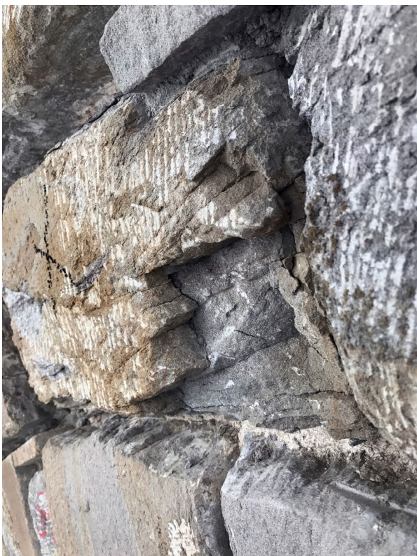
Eindrucksvoll zeigt dieses Foto von 2016 die Steinschäden in der Außenmauer des Turms.
