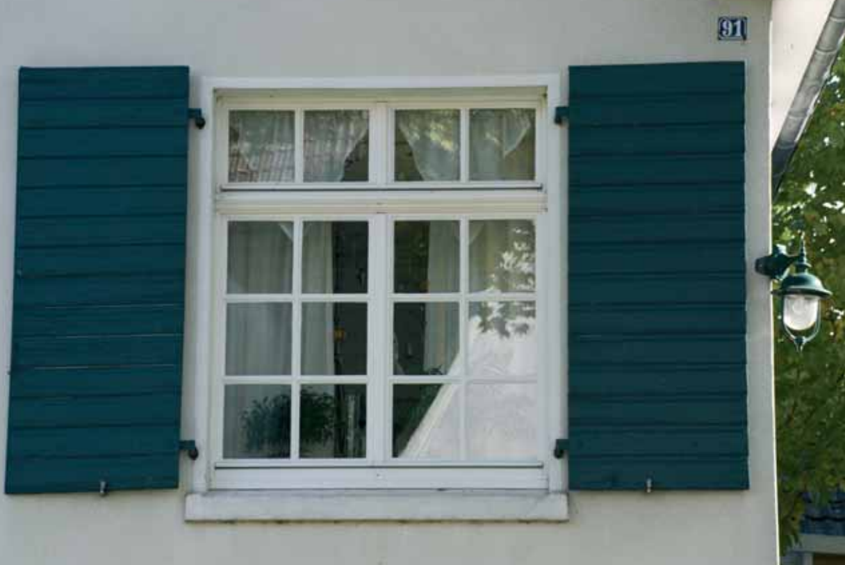
Abb. 19 Eine neues Fenster mit historischen Läden im Sinne des ursprüng- lichen Gestaltungs- konzeptes.
