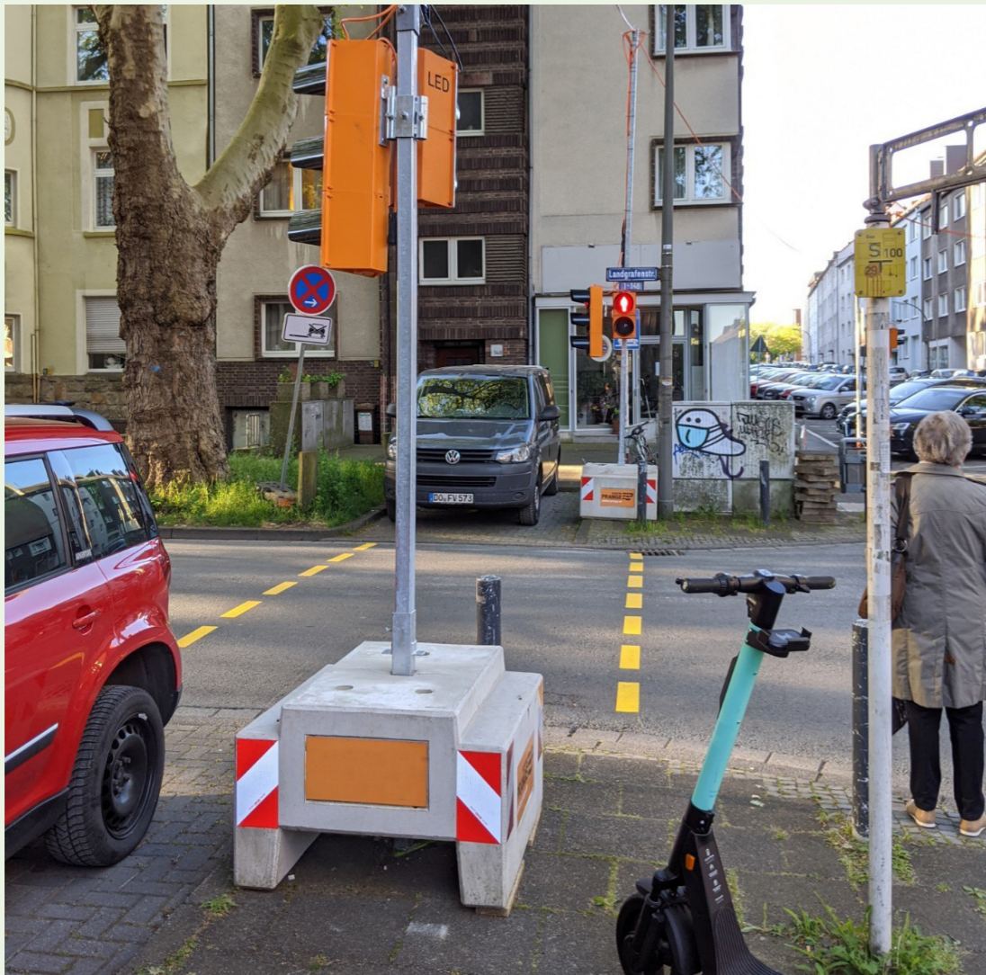
Abbildung 17: Falschparken in einer gesicherten Baustellenführung
