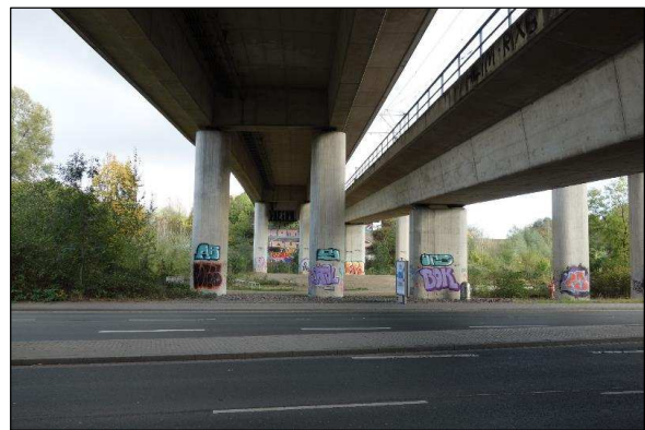
Schmierereien unter der Brücke Mallinckrodtstraße, Richtung Osten
