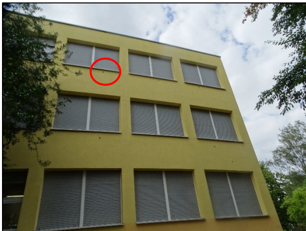
Abb. 24: Loch an der Ostfassade in dem ein Nest (wahrscheinlich von einer Meisenart) nachgewiesen wurde.
