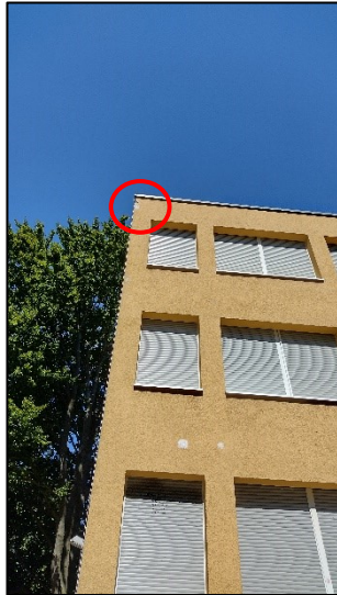
Abb. 25: Loch an der Südfassade, in das eine Dohle einflog. Aufgrund der Höhe konnte das Loch nicht mit dem Endoskop kontrolliert werden.
