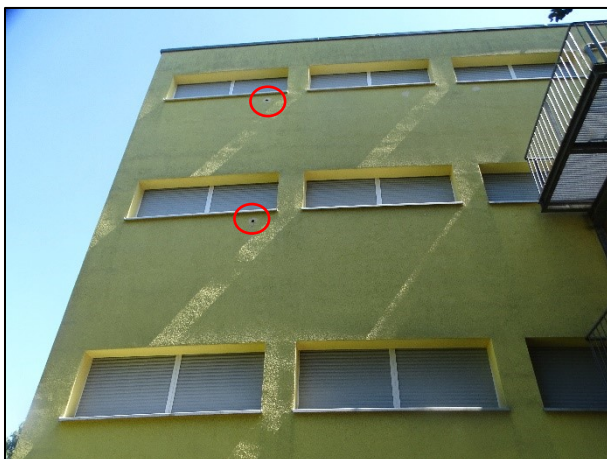
Abb. 3: Westfassade des südlichen Gebäudes mit einigen Spechtlöchern.
