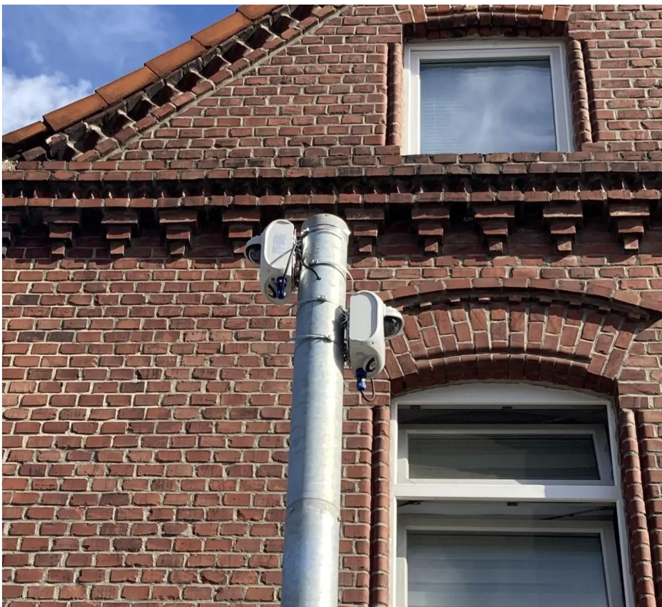
Sölder Straße/Nathmerichstr: Die neuen Wärmebilddetektoren an einem neuen Mast
