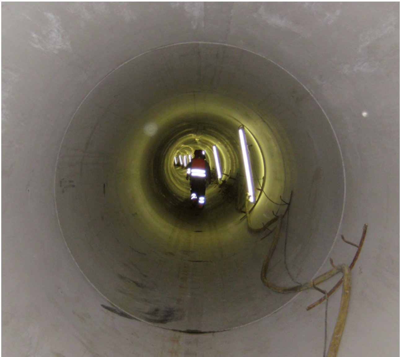
Abbildung 27: Regenrückhaltekanal Tremonia am 09.02.2009
