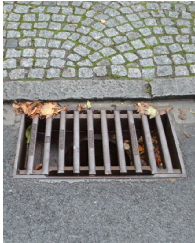
Abbildung 24: Überbreiter Sinkkasten An der Margaretenkapelle
