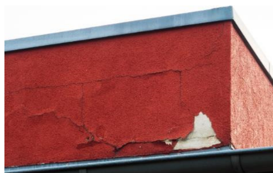
Negativ: Südseite einer Hauswand mit Hitzeschaden (Foto: K.PLAN)
